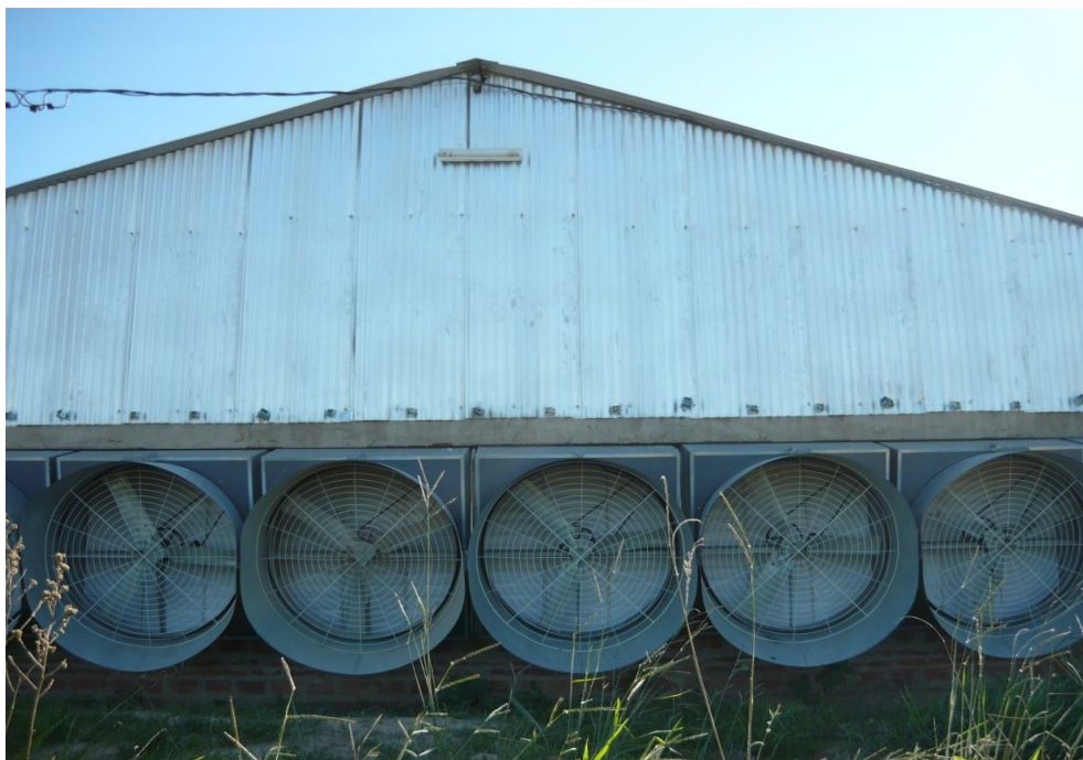
GRAFICO # 20. GALPONES TUNEL CON VENTILACION NEGATIVA.
